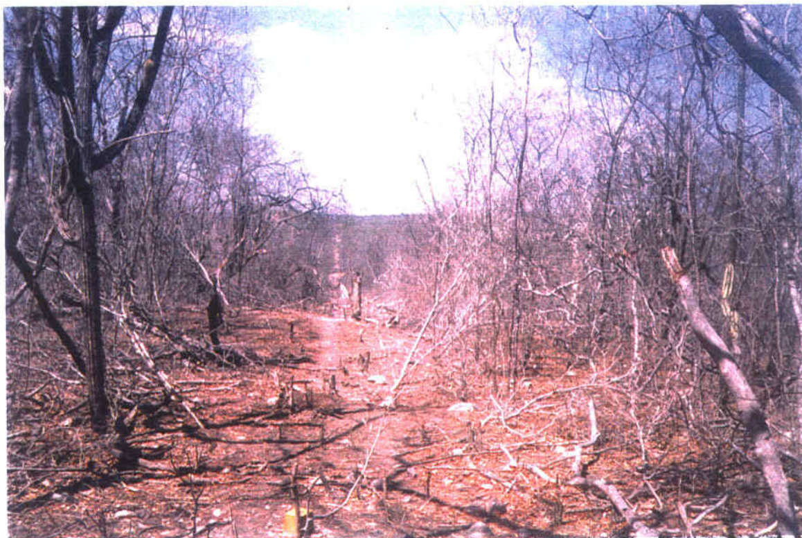
Foto 2- Marco inicial da picada (ombreira direita) no eixo da barragem em direção à ombreira esquerda.
